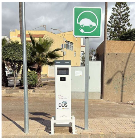
Cargador eléctrico de vehículos en Calle Vélez Rubio
