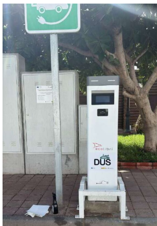
Cargador eléctrico de vehículos en Avenida del Mar
